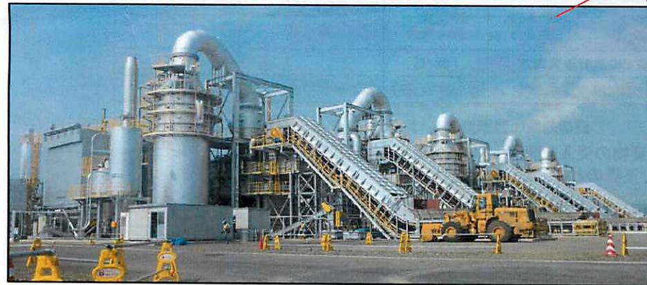
焼却炉(105t/日×5基)
