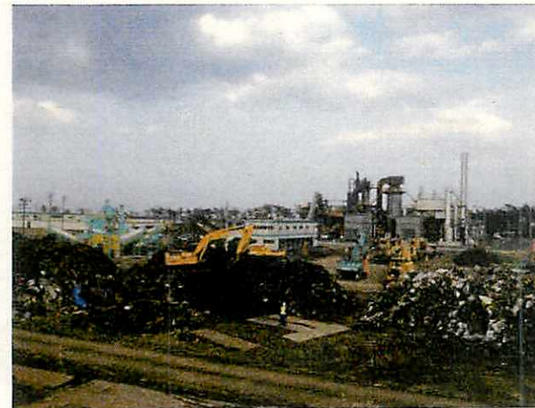
分級・選別ヤード及び焼却炉ヤード
