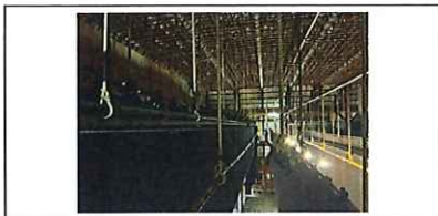
フライタワーの高さが低いため、バトンに設置された道具が飛びきらない
