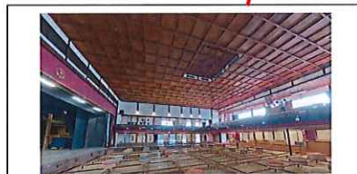
シーリングライトが無く、舞台正面からの明かりが十分でない
